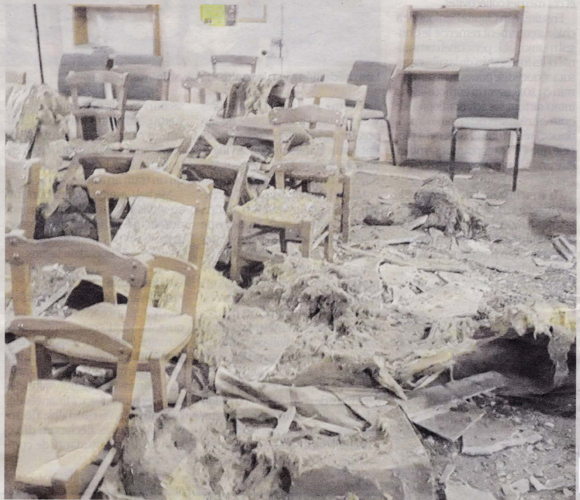
L'effondrement d'une partie du plafond laisse le temple de la place Pancaut sens dessus dessous. Le pasteur redoute la découverte d'autres dégâts au passage des experts. PHOTO DR
